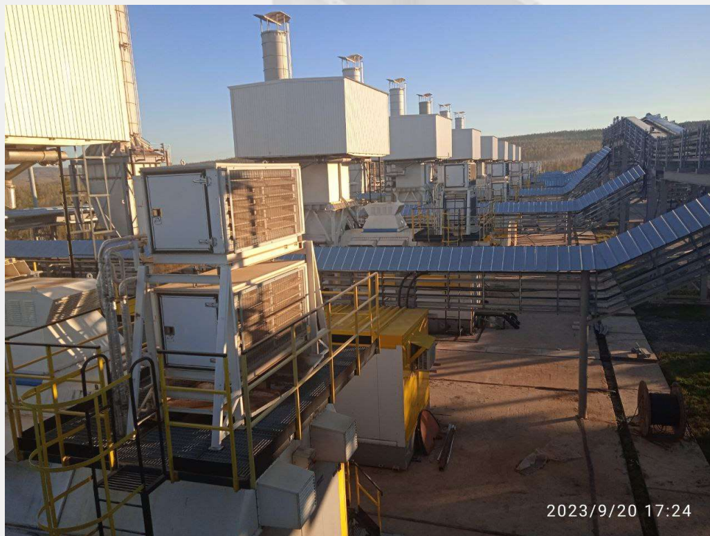
ГТЭС ЭСН-2 Юрубчено-Тохомское нефтегазоконденсатное месторождение, Красноярский край
