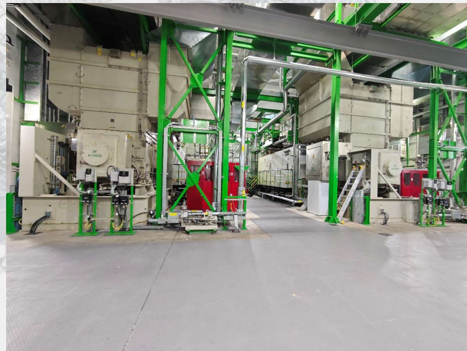
ТЭС-2 Харьгинского нефтяного месторождения, ГТУ Titan-130 производства Solar Turbines
